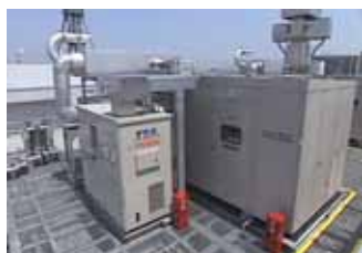
コージェネレーションシステム
