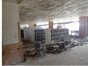
平成30年7月豪雨の被害
