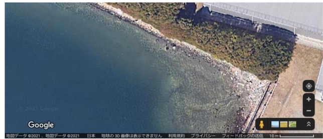
図3-7 砂の堆積が見られる護岸の例
