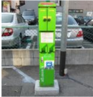
電気自動車等の充電設備
