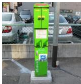
電気自動車等の充電設備
