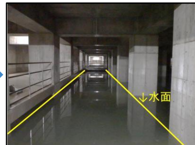
西郷通調節池 (貯留時)
