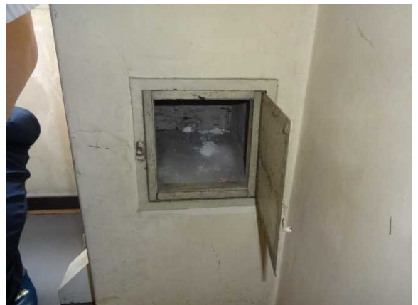
写真⑦（石綿セメント円筒）
