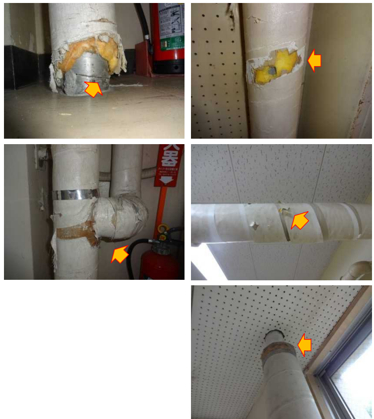
写真②（劣化・損傷の状況）
