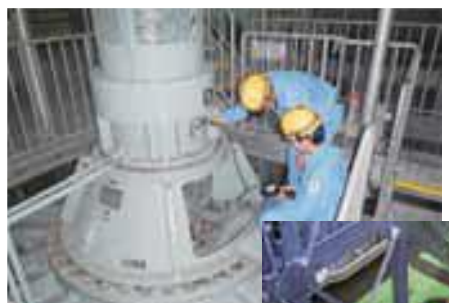
雨水ポンプの診断
