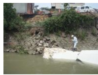
河川管理施設(構造物の損傷)
