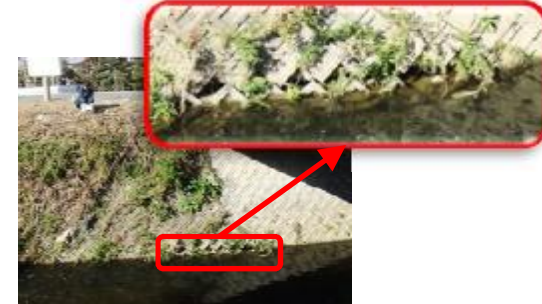
河川巡視点検(河床低下)
