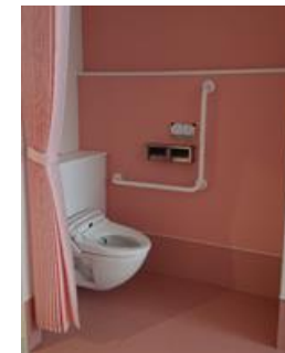
居室内トイレ
