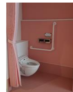
居室内トイレ
