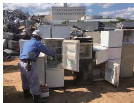
仮置場での冷蔵庫の中身の除去作業 捨てられた冷蔵庫に食品が入ったままだと、処理業者に引き渡す前に手作業で取り除かないといけません。かなりの時間がかかるため、悪臭や害虫発生の原因になる場合も…
