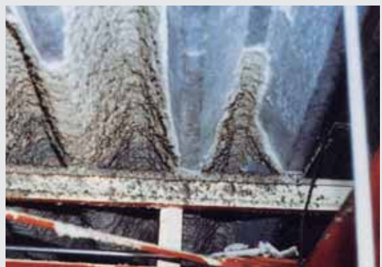
⑥層の損傷・欠損
