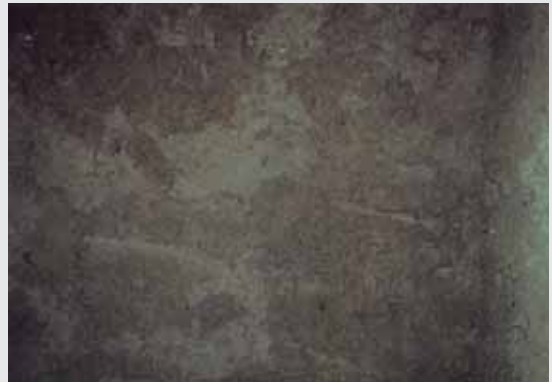
④下地と石綿層の間の浮き・はがれ
