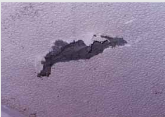
⑤層の局部的損傷・欠損
