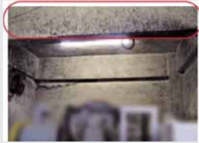
機械室吸音材
