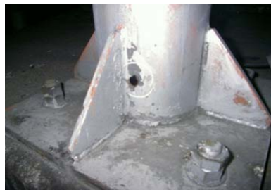
(外見は一見健全であったが、たたき点検で孔が開いた例)
