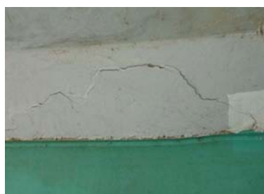
(モルタル片剥落前；定期点検時)
