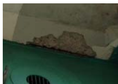
(モルタル片剥落后)
