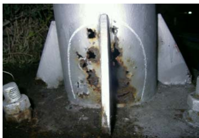
腐食が表面まで及んだ例
