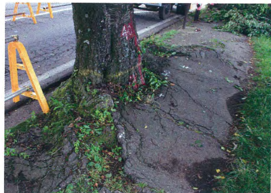
幹が肥大し、舗装を押し上げている事例
