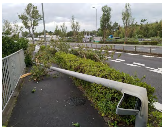
照明灯の倒壊（国道170号）
