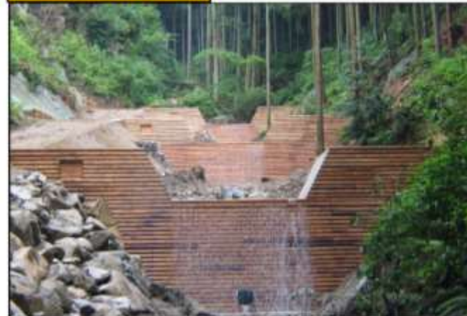
治山ダムの設置により、渓流勾配を緩和し土石流の発生を未然に防止
