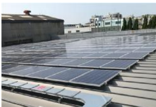
太陽光パネル（屋上）
