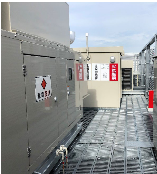
防災・保安兼用発電機＋燃料タンク
