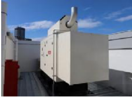
非常用発電機で電源のバックアップ対応
