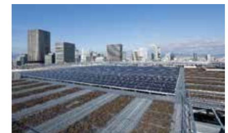
【4】太陽光パネル・屋上緑化
