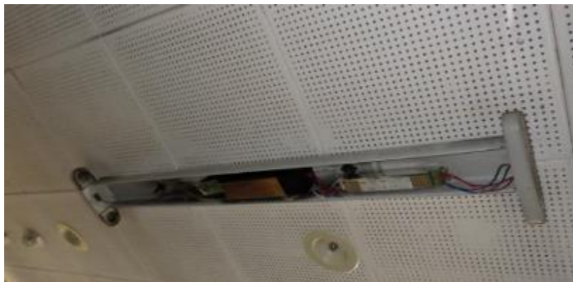
LED化照明器具内部（本体は未交換）
