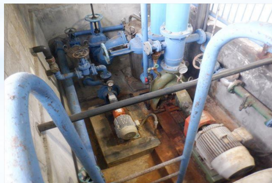
排水等ポンプ設備
