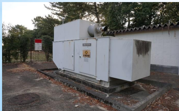
自家発電設備
