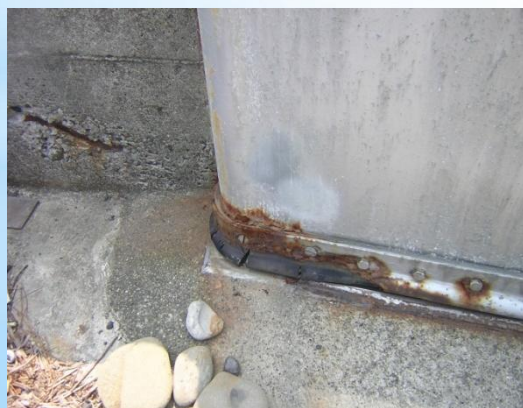
水密ゴムの亀裂
