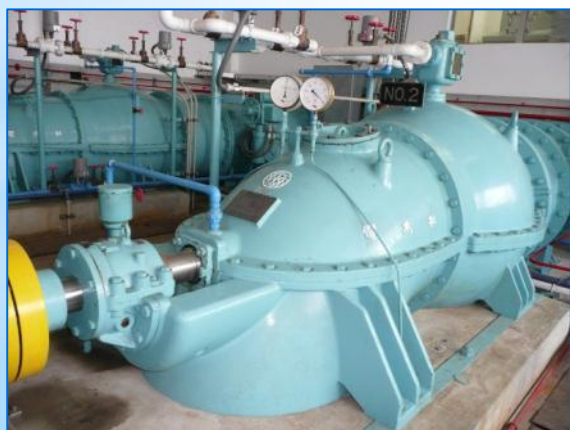
排水施設(ポンプ)
