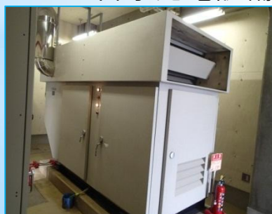
自家発電設備
