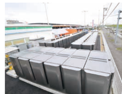
1.2メガワットの燃料電池(SOFC) 平成27年3月~供給開始
