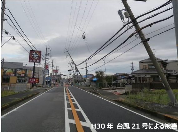
【電柱倒壊等による道路閉塞】
