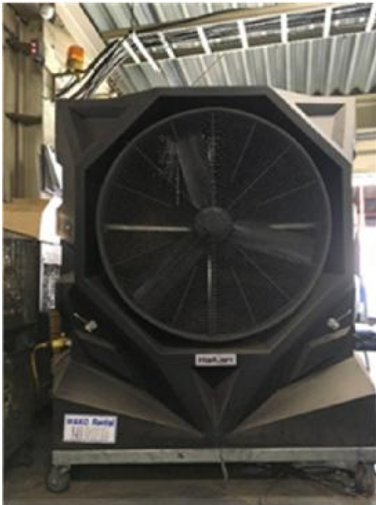
鑄造工場に設置した大型ファン（高さ1,800mm） （2017年8月設置）
