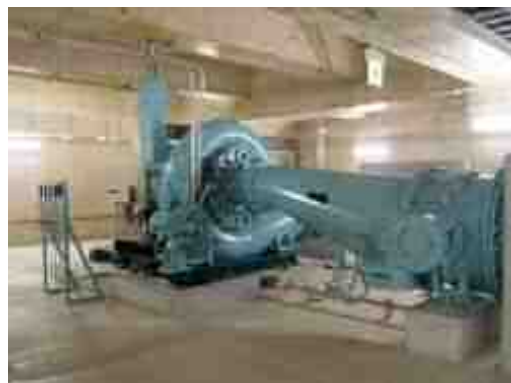
長居水力発電設備
