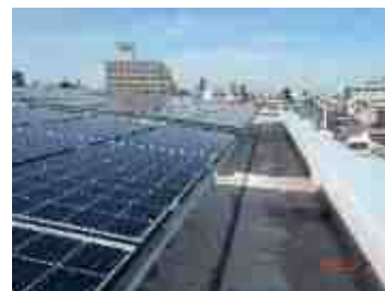
設置例:大阪市立東桃谷小学校
