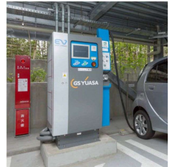
EV急速充電器(PV、蓄電池と連携)
