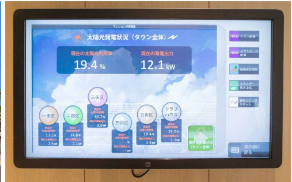
エントランスホールのデジタルサイネージ
