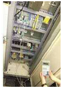
空調機ファンインバータ調整
