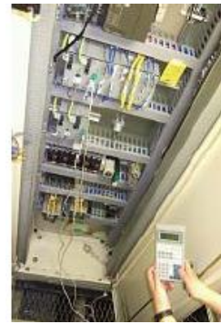
空調機ファンインバータ調整
