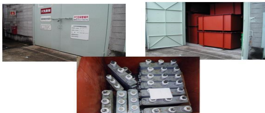
図4 PCB廃棄物保管例
