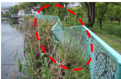
ネットフェンスの転倒
