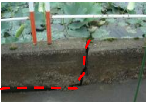
基礎ブロックの破損
