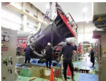
写真6 機械設備の改築更新の例(ポンプ)
