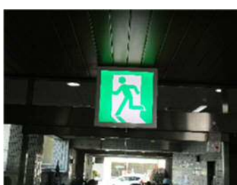
【LED 化された非常用照明】
