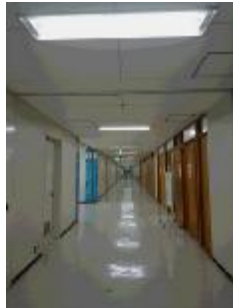
【LED化された共用部】
