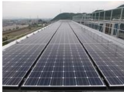
【太陽光パネル】
