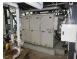
【更新後の冷凍機】
