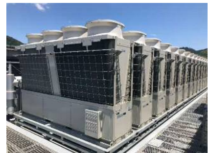
【更新後：インバーター式モジュールヒートポンプ空冷チラー】
