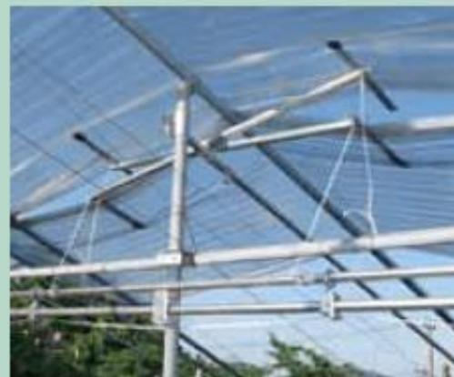
ぶどうハウスの自動換気装置
