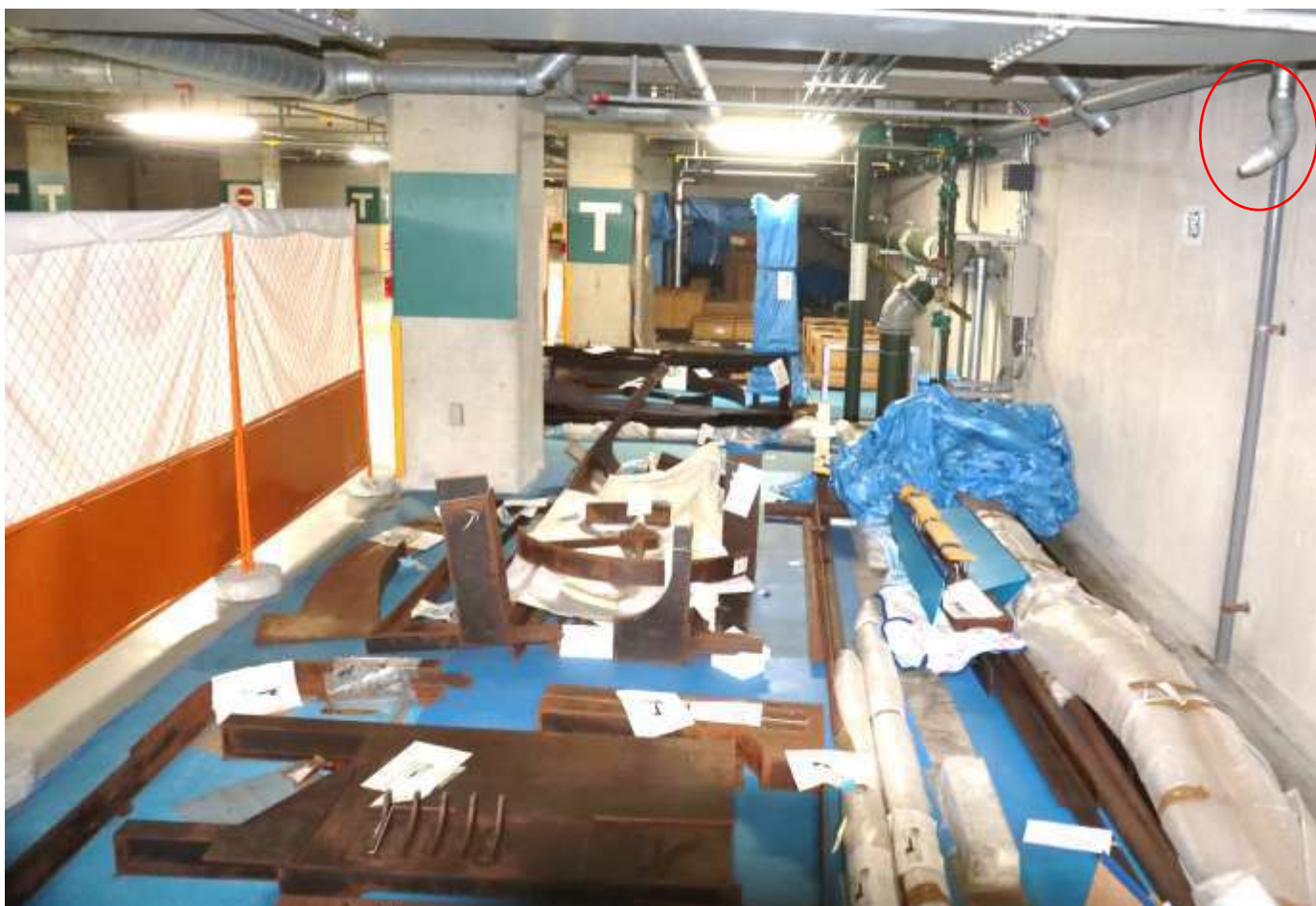
赤の楕円は外気吹き出しダクト。外気が直撃する個所は発錆が目立つ。
