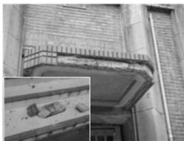
▲外壁タイルの剥落
