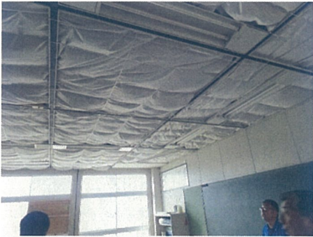
天井材の破損(システム天井)
