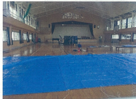
ステージ側外装材の脱落(内側)
