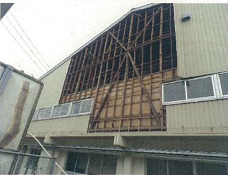
ステージ側外装材の脱落(外側)
