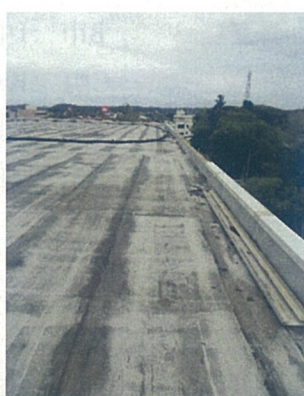
屋上笠木破損
