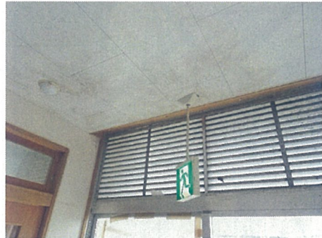
強風吹付による換気ガラー汚損
