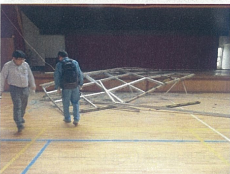
落下した横連窓
