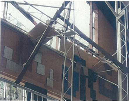
外装材支持柱の損傷
