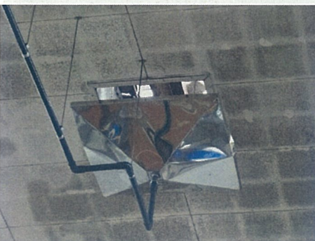
換気塔の破損状況(空が見える)
