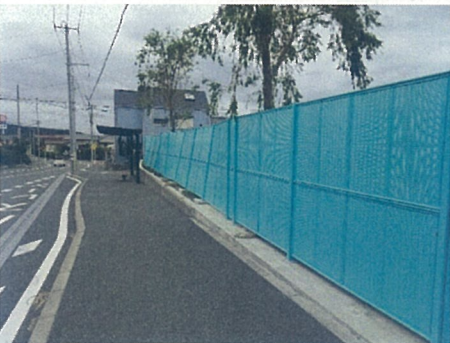
目隠しフェンスの倒れ
