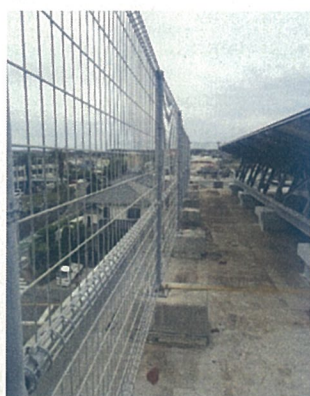
屋上フェンス傾き
