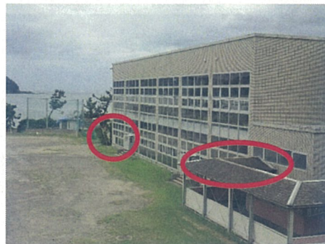
体育館窓ガラス破損(左)、渡り廊下棟包み破損(右)
