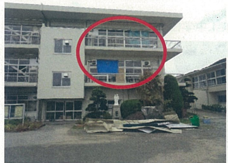
校舎窓ガラス破損
