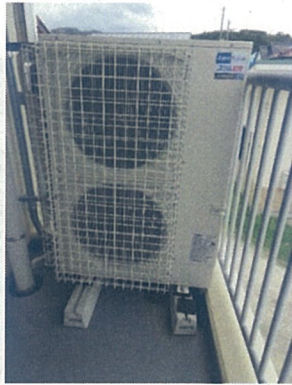
空調機内部破損
