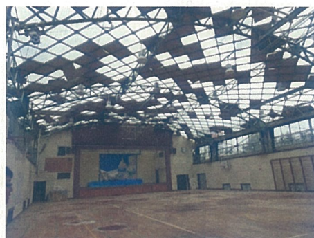
屋根構造材を残して屋根葺き材は完全に消失、 下地材も多数飛散および落下
