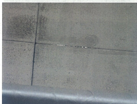
調理場屋根破損(天井材の隙間から光が見える)
