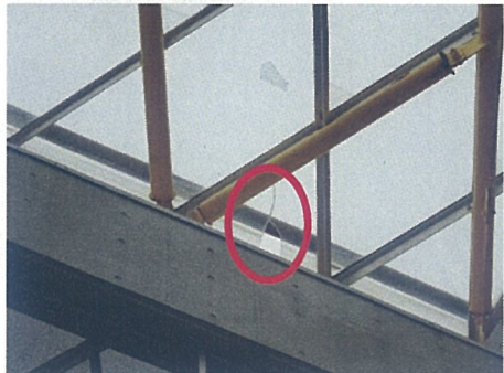
外部大屋根のガラス破損
