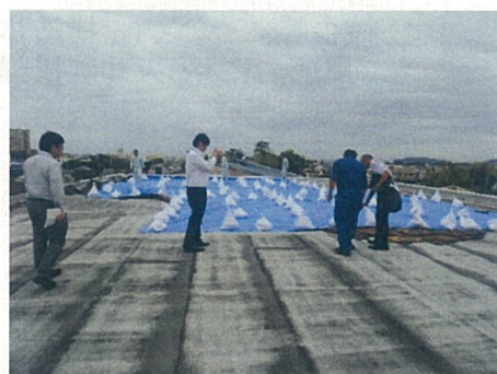
屋上断熱防水の剥がれ
