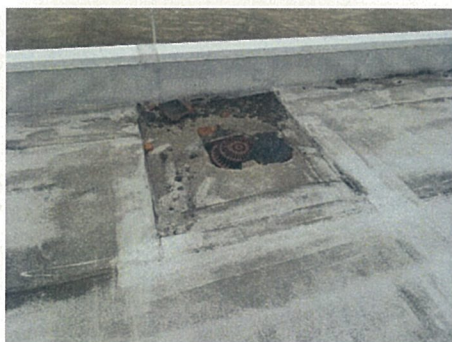
ドレン周りの防水破損
