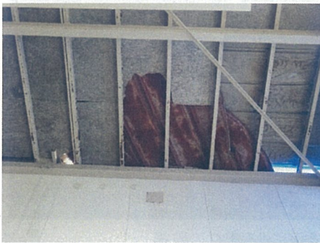
給食搬入出場の屋根材めくれ及び天井材の破損
