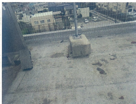
屋上フェンス基礎のずれ
