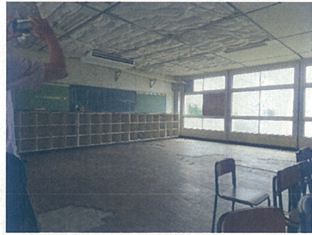
窓ガラス破損で風が侵入し天井材が破損、浸水による床材の破損
