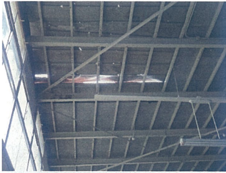
給食搬入出場の屋根材めくれ及び天井材の破損(内部からは確認しにくいですが、広範囲にわたって外側の屋根材がめくれ、一旦めくれを戻したとのこと)
