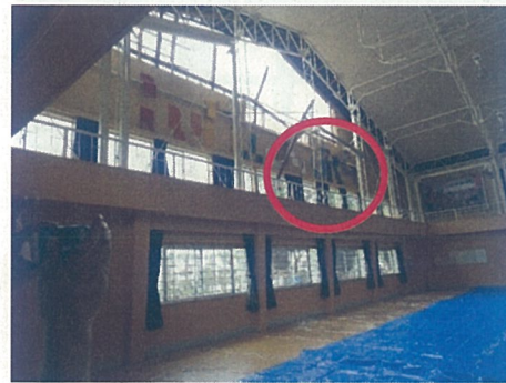
体育館外装材の破損及び支持柱の損傷(丸囲み)
