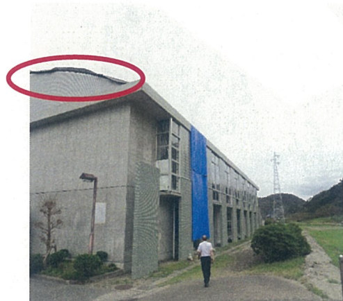
軒包みめくれ、アルミサッシュ障子脱落、およびガラス破損
