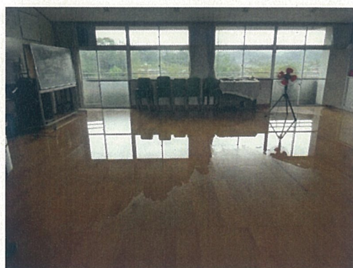
2階普通教室ベランダからの浸水
