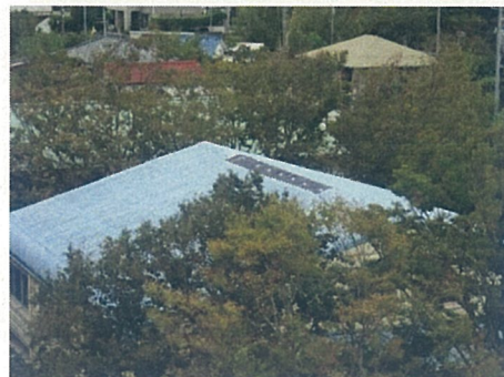
武道場屋根包みの破損
