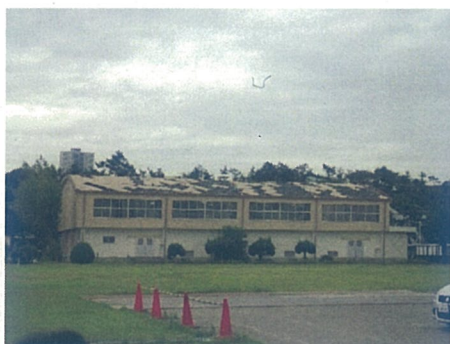
体育館屋根葺き部材全消失 (残って見えているのは下地材)
