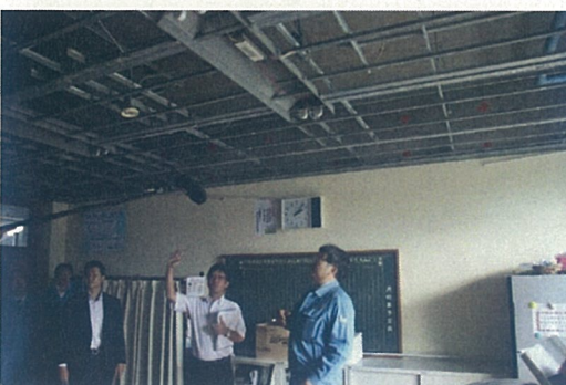
1階コンピューター室の天井の被災
