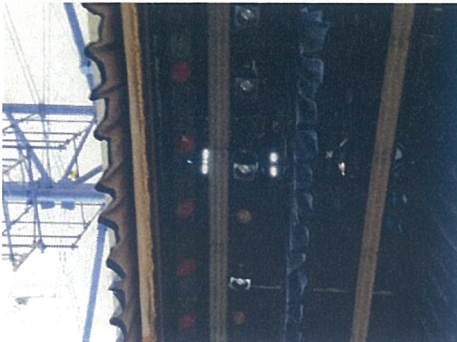
ステージ上部の屋根部材破損(天井材隙間より光が見える)
