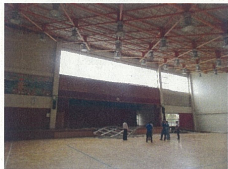
体育館横連窓の脱落
