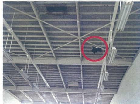
調理場換気塔落下による屋根破損
