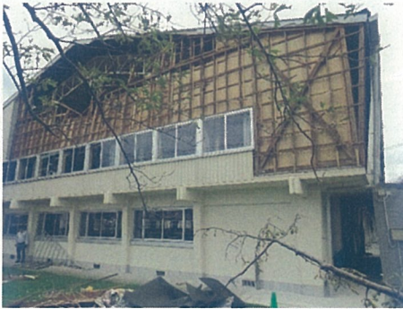
体育館外装材の脱落(外側)
