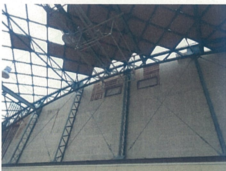
壁部材の雨水による破損
