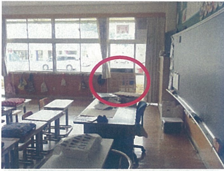
窓ガラス破損
