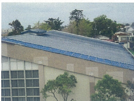
カバー工法による改修屋根部材剥がれ(雨漏り無し)
