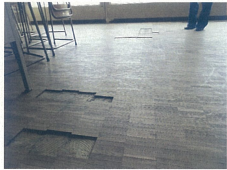
浸水による床材の破損
