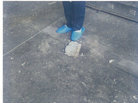
天井材(セメント木毛板)の落下
