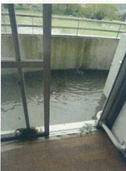
飛来物によりベランダの排水口が詰まり、オーバーフロー管等もなく、2階普通教室に浸水
