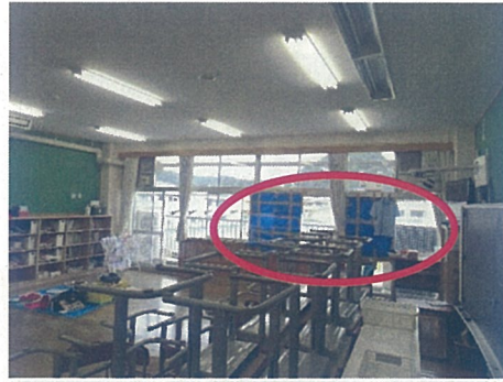
窓ガラス破損
