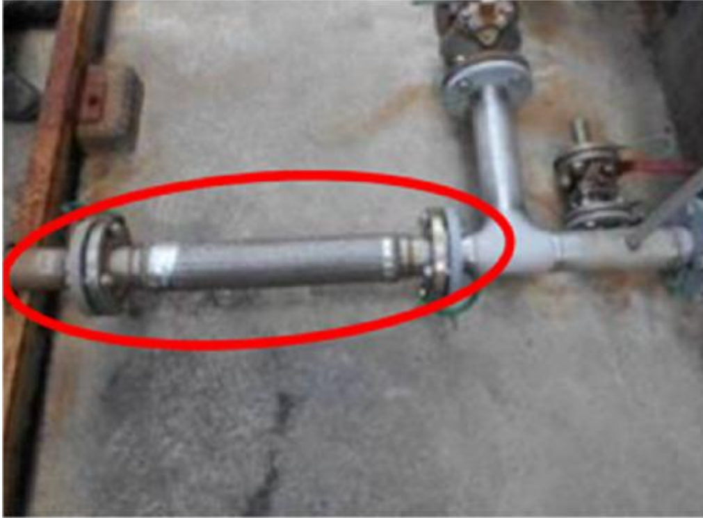
フレキシブル配管
