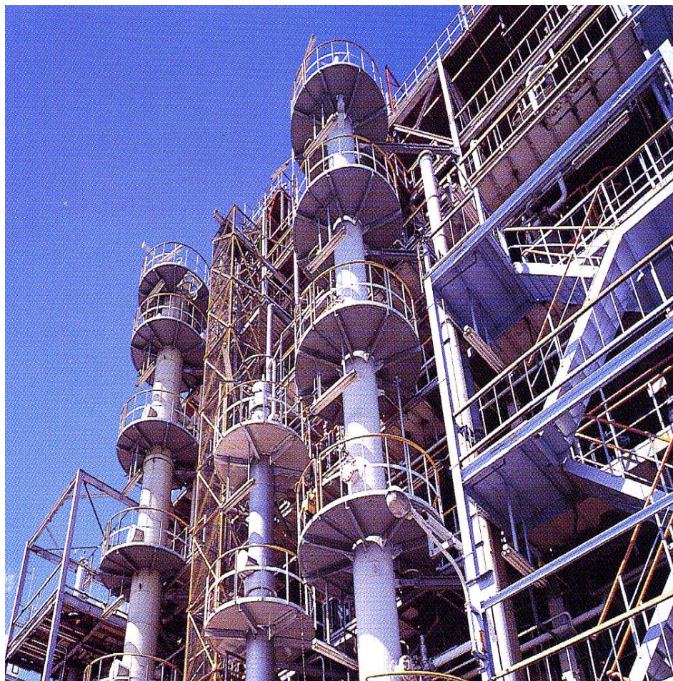
HFC-32 プラント
