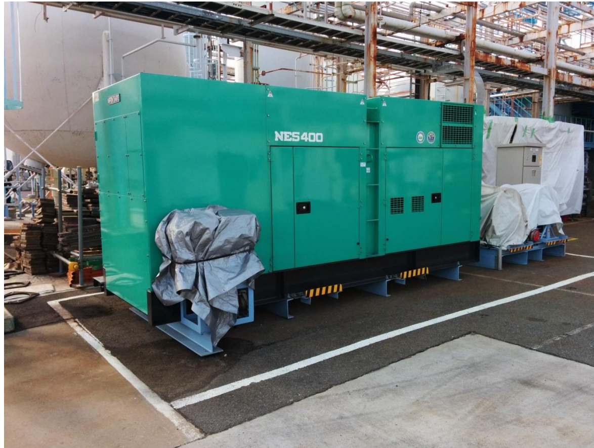
可搬式発電機
