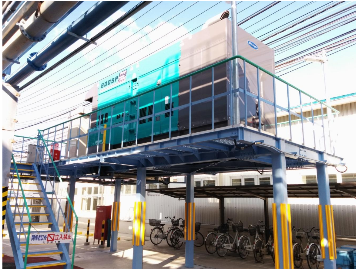
非常用電源設備(浸水対策済み)
