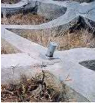
写真 受圧構造物の破損の例
