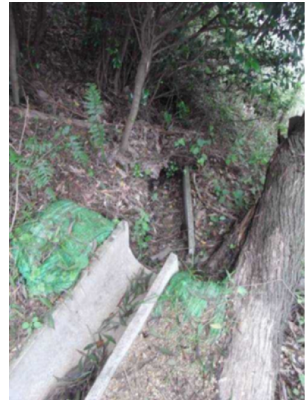
写真 排水溝の破損の例
