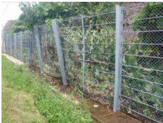
写真 落石防護柵の傾動の例
