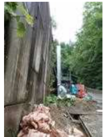
写真 壁面の傾斜の例
