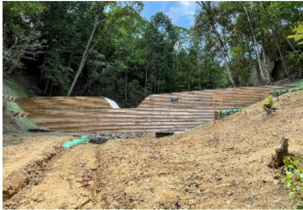
治山ダム（四條畷市下田原地区）
