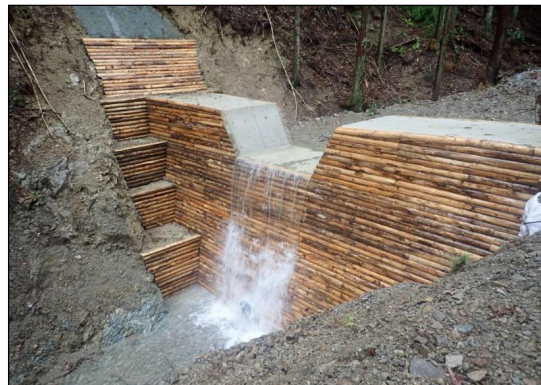
治山ダムの設置により、溪流勾配を緩和し、土石流の発生を未然に防止(貝塚市)
