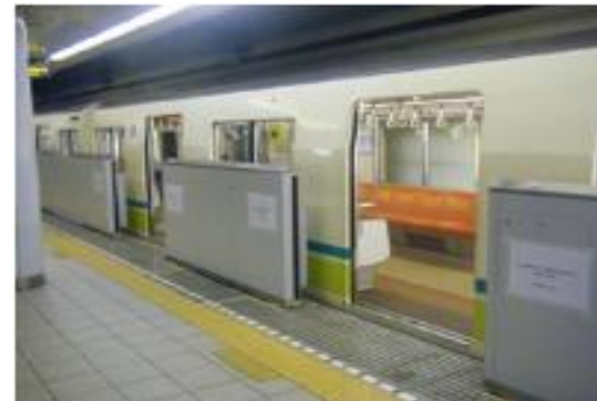
可動式ホーム柵の設置状況
