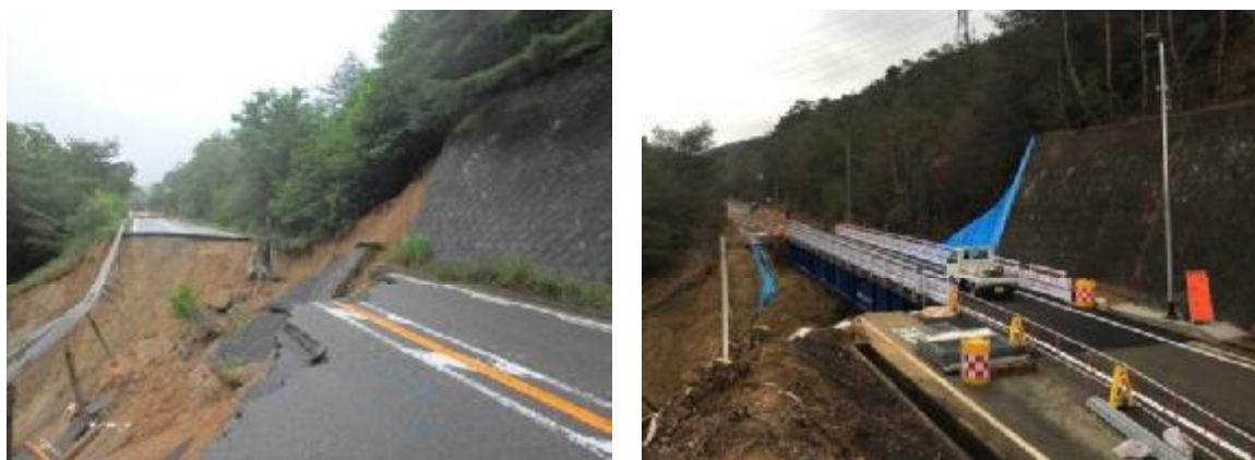
写真-2.1 国道173号 能勢町山辺（左：被災直後、右：現在（暫定交通開放））
